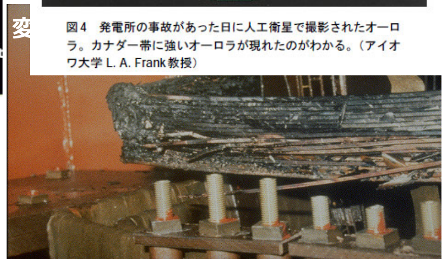
故障したSalem原子力発電所の変圧器
